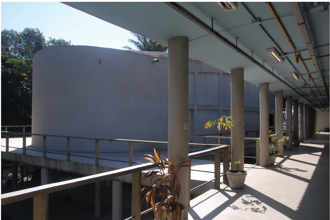
Figura 4 | Bloco do auditório onde podem ser observadas as marcações dos antigos vãos protegidos pelos brises. Fonte: DPH/COC/Fiocruz (2016).
