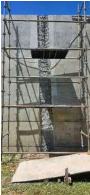
Figura 13: Abertura de trecho com trinca.
