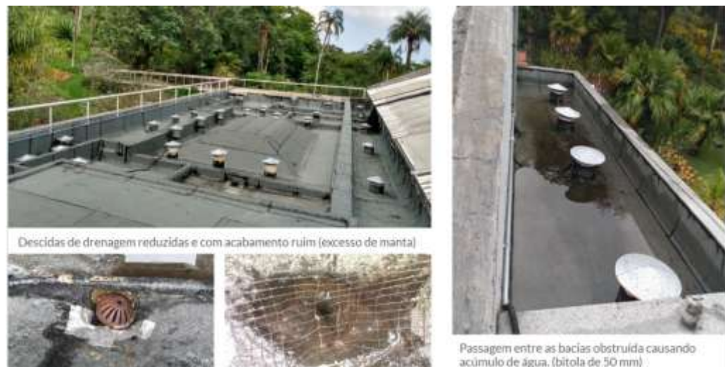
Figura 17: Descidas de água pluvial mal executadas e acúmulo de água superficial.
