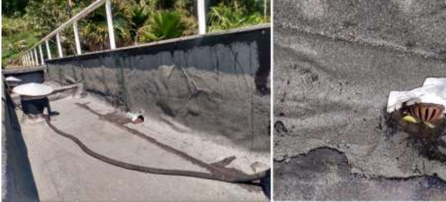
Figura 15: Descolamento da manta de impermeabilização nas paredes laterais e laje.
