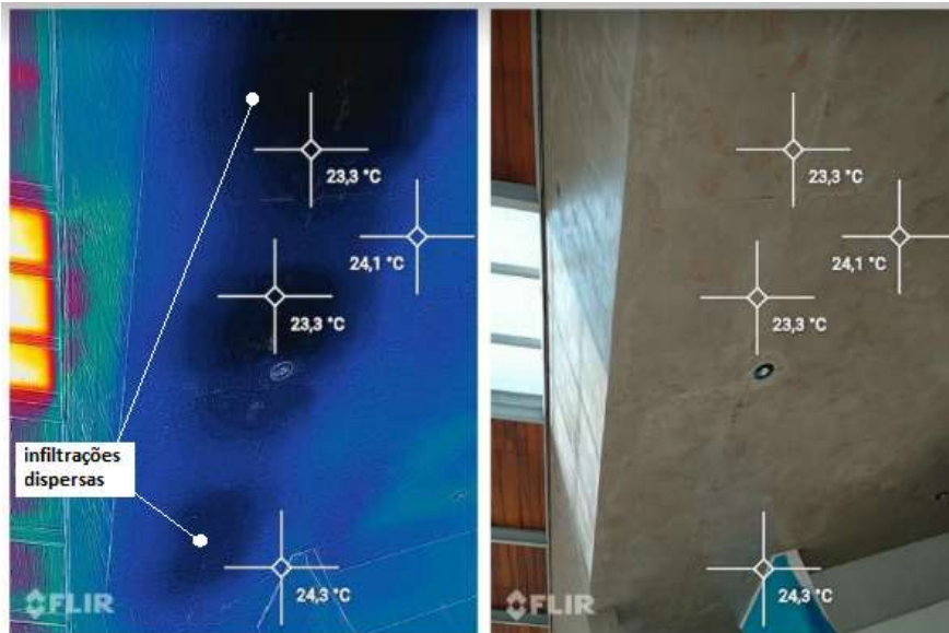
Figura 18: foto termográfica (à esquerda) e foto comum (à direita) do teto da área do mezanino.
