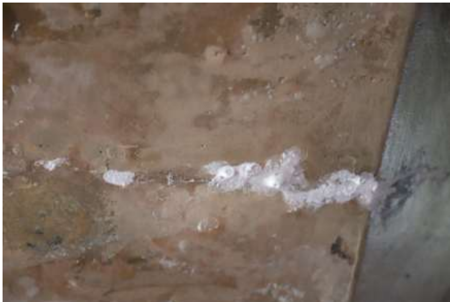
Figuras 19: fissura com eflorescência do teto do mezanino.
